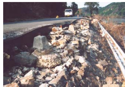
Zničená silnice na Prahu.
