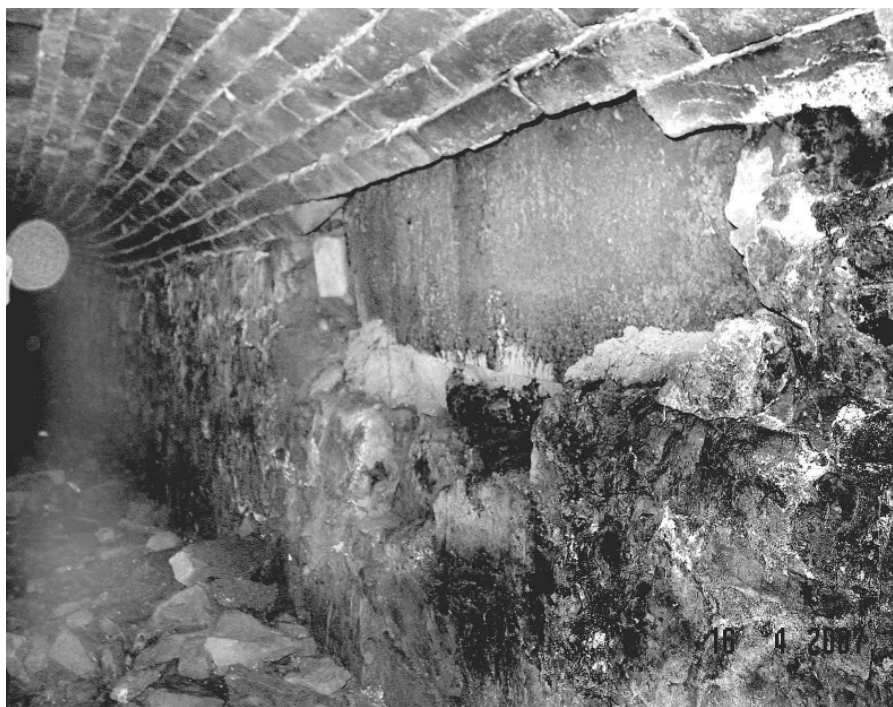
Dávná „oprava“ vyvaleného boku štoly plechem!
