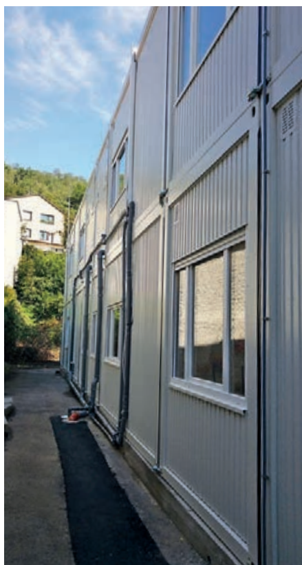
Toto jsou kontejnery, které by se po demontáži (možná někdy v příštím roce) měly převézt do Roztok. Jeden z nedořešených detailů kontejnerové varianty provizorní školy – odpady a voda jsou vedeny po vnějším plášti. Co se stane, když přijdou takové mrazy jako letos v únoru?
